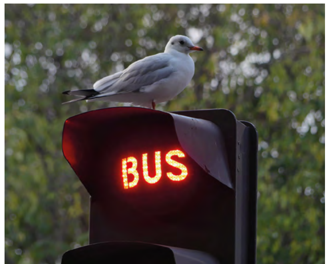
Ce feu déclenche le vert en avance de phase favorisant la circulation des bus (et des vélos)
